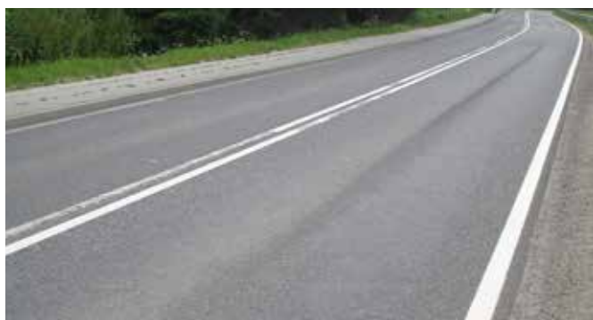
Fot. 3. Ślady traseologiczne na nawierzchni asfaltowej i krawężniku. Zdj. dr inż. R. Janczur, biegły sądowy.
