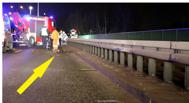
Fot. 1. Miejsce zdarzenia – strzałką zaznaczono obszar odłamków szkła i tworzywa sztucznego.
