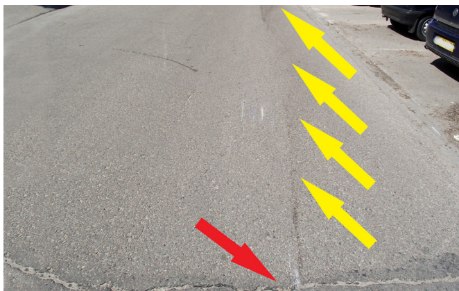
Fot. 20. Czerwoną strzałką zaznaczono zarysowanie nawierzchni jezdni powstałe w wyniku przewrócenia się motocykla, żółtymi – ślady paliwa.
