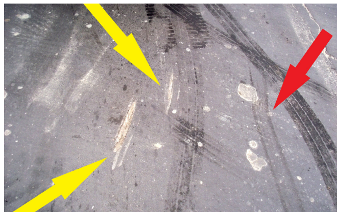
Fot. 17. Zdjęcie szczegółowe: czerwoną strzałką zaznaczono miejsce załamania śladu blokowania koła, natomiast żółtymi – zarysowania nawierzchni jezdni.
