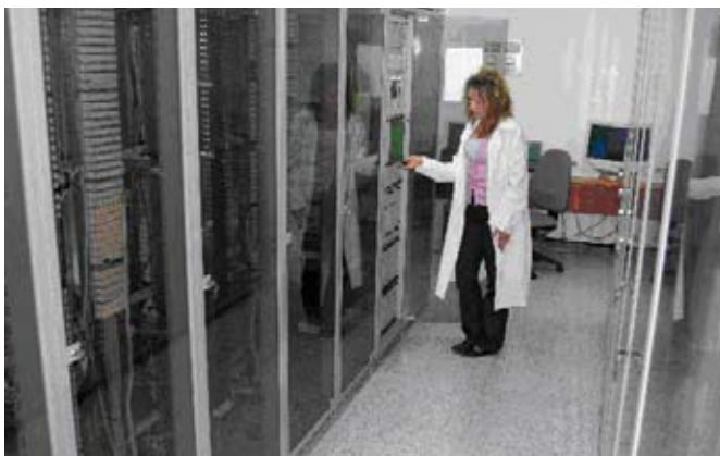
■ Węzeł teleinformatyczny w KGP. Fot. G. Proczek
