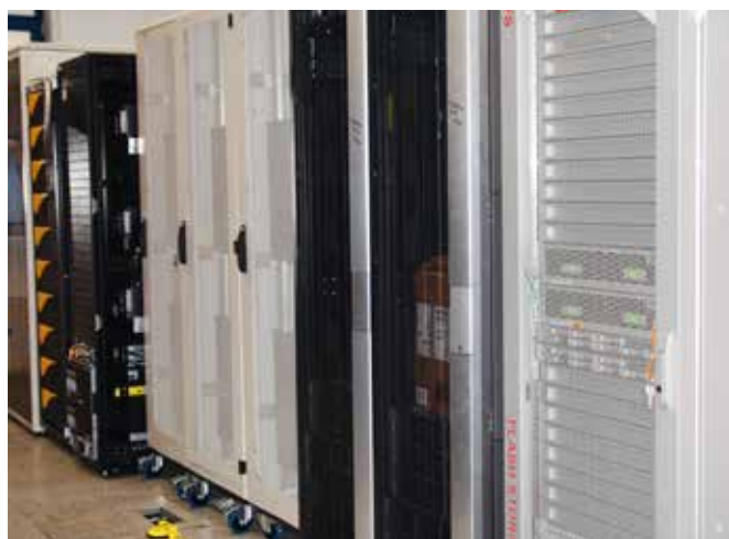
Serwerownia Błil KGP. Fot. Katarzyna Lipińska. Źródło: Błil KGP.
