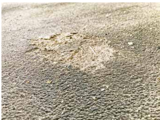
Fot. 6. Lej w podłożu betonowym. Zdj. K. Poloczek.
