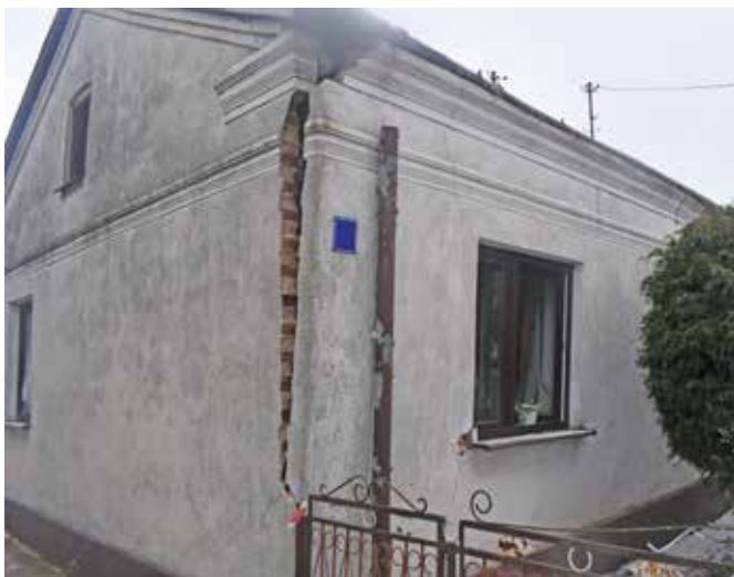
Fot. 2. Powybuchowe uszkodzenia konstrukcji budynku. Zdj. K. Molski.
