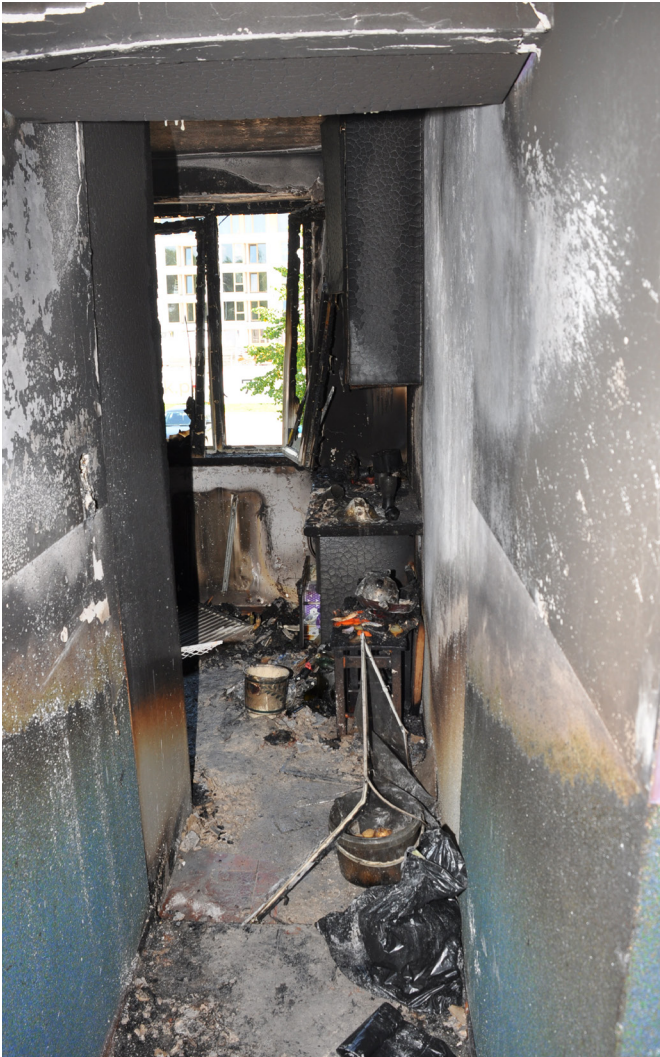
Fot. 4. Miejsce pożaru.
