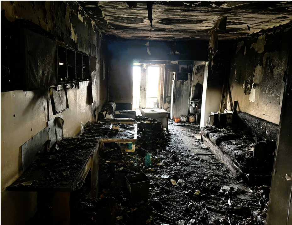
Fot. 2. Miejsce pożaru.
