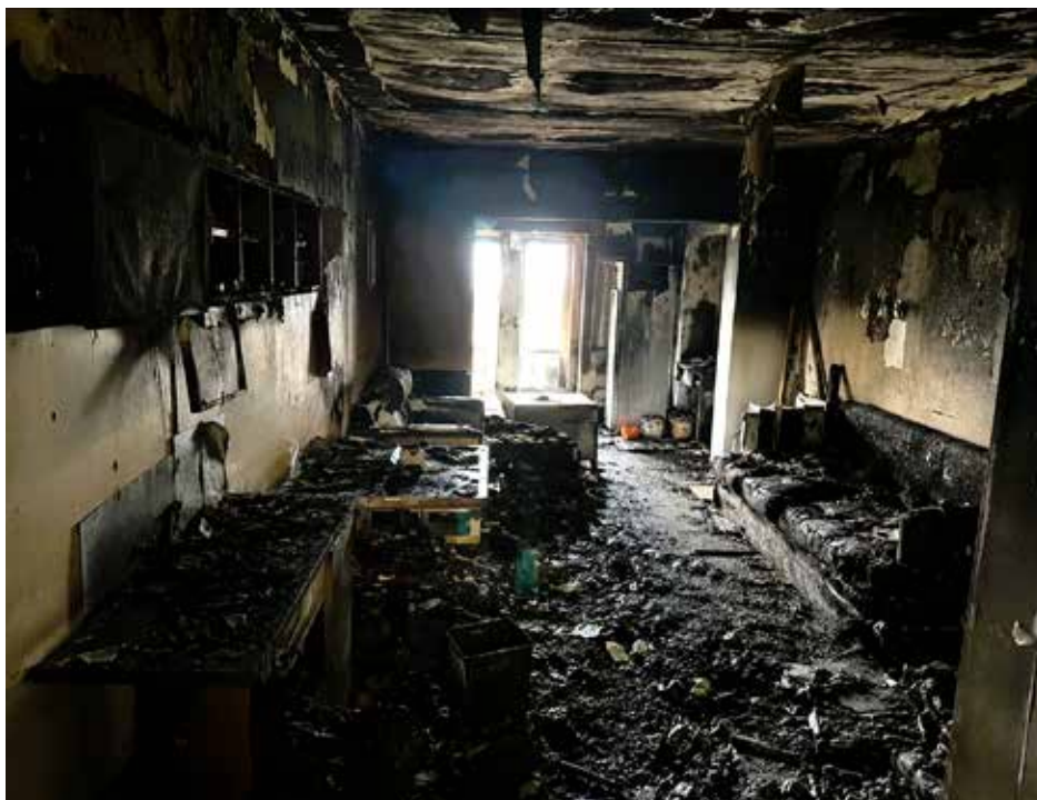
Fot. 2. Miejsce pożaru.
