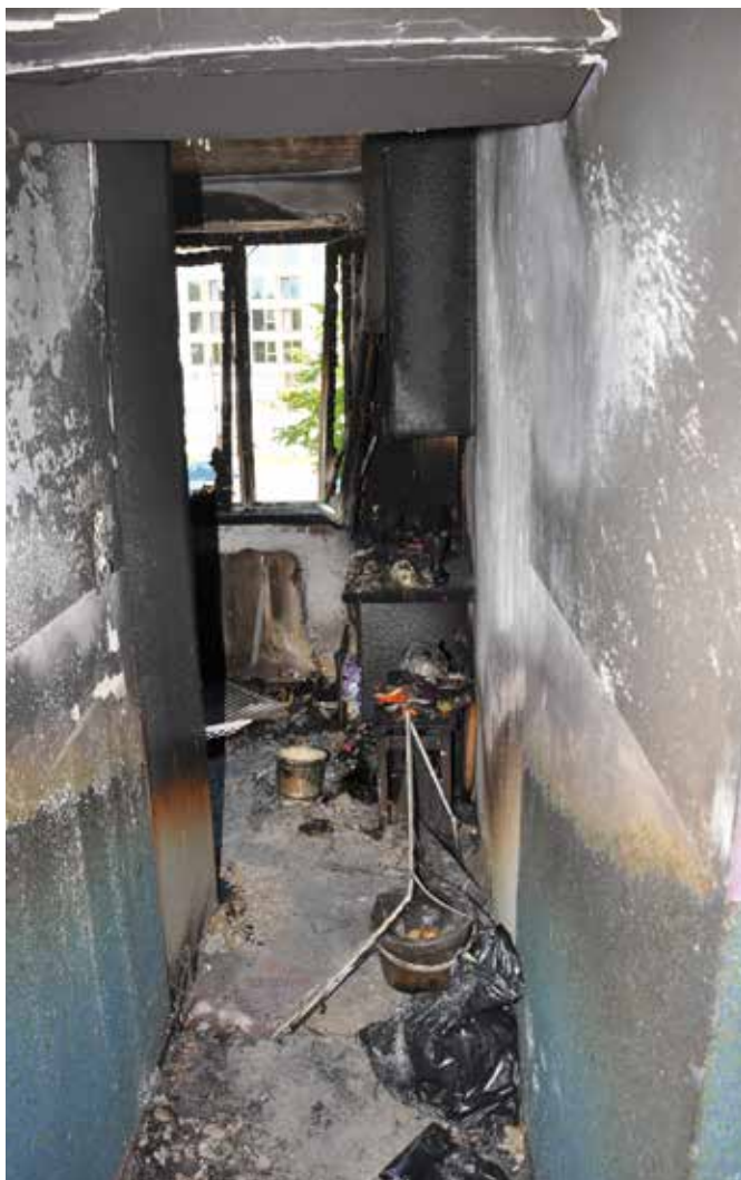
Fot. 4. Miejsce pożaru.
