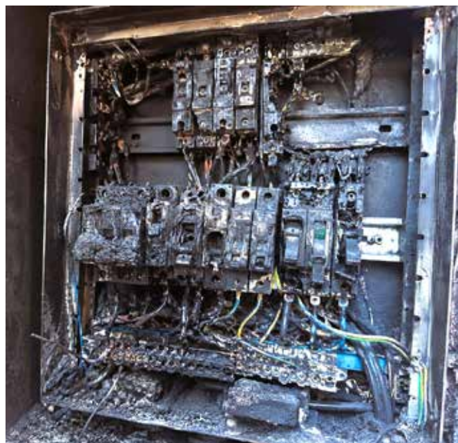
Fot. 5. Instalacja elektryczna.
